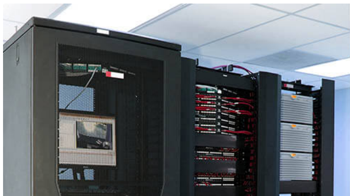
Salle des serveurs
